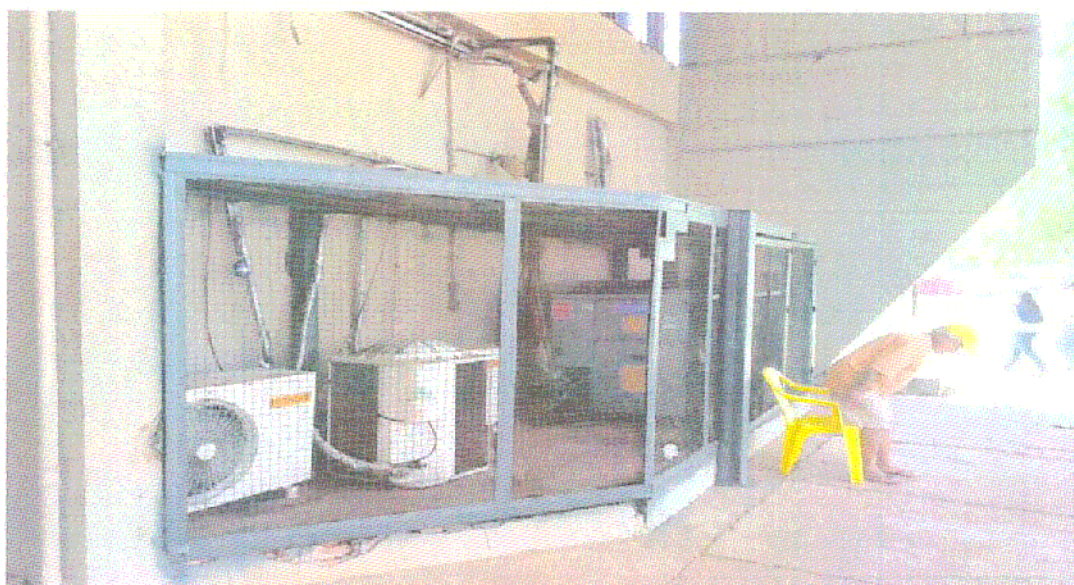
Área Técnica (climatização)
