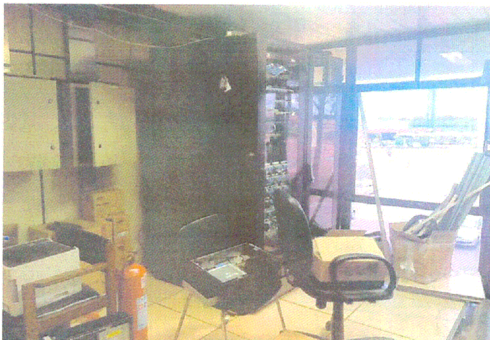
Deposito da Gerencia de Informática
