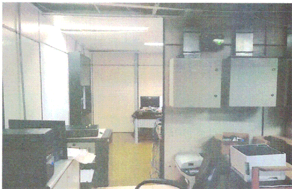
Deposito da Gerencia de Informática
